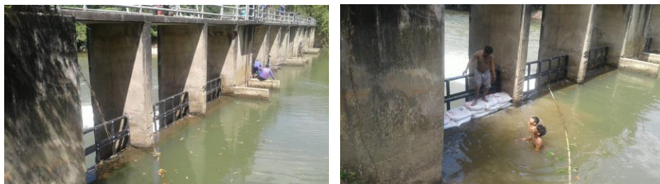
การเสริมฝายวังใหม่ ในคลองวังโตนด เพื่อระบายน้ำจากอ่างฯ ประแกด มายังอ่างฯ ประแสร์ 10 ล้านลบ.ม.
